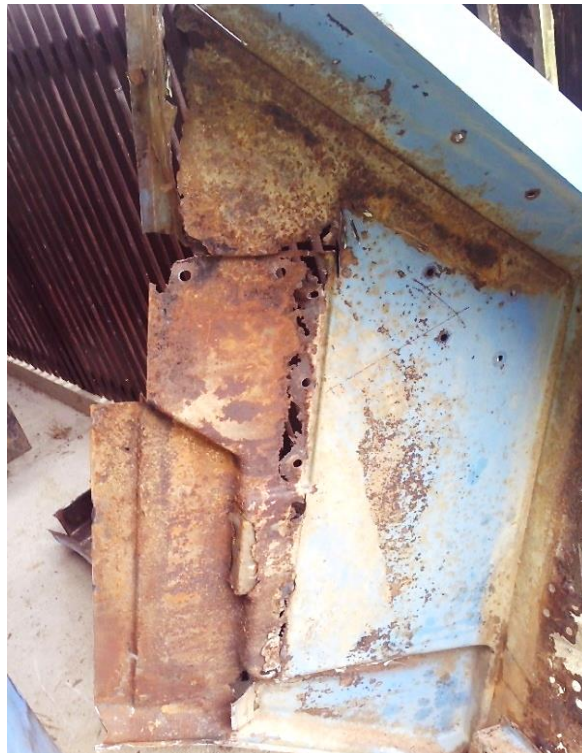
Slika 5: Korozija in dotrajanost blatnika na notranji strani Vir: Berghaus 202
