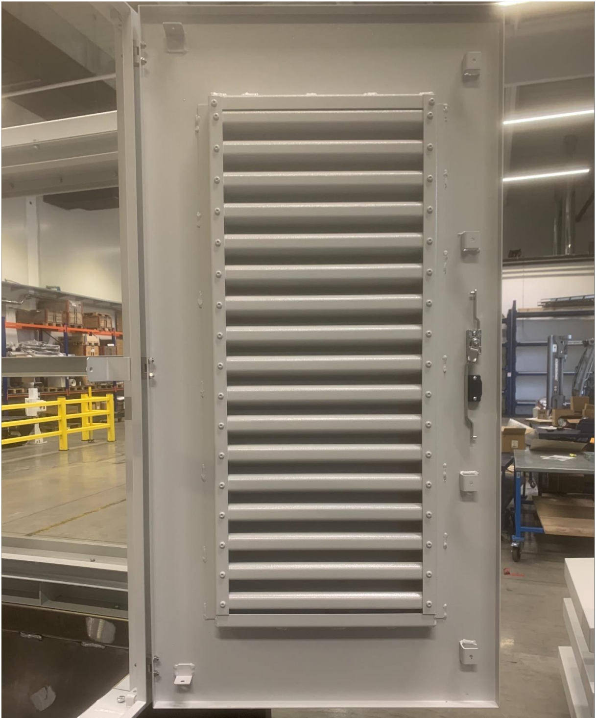
Slika 27: Vrata za dostop do transformatorja
