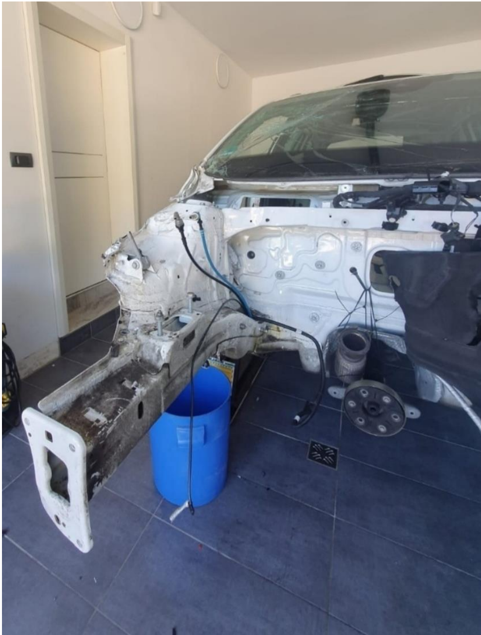
Slika 16: Demontiran notranji desni del poškodovanega kraka vozila
