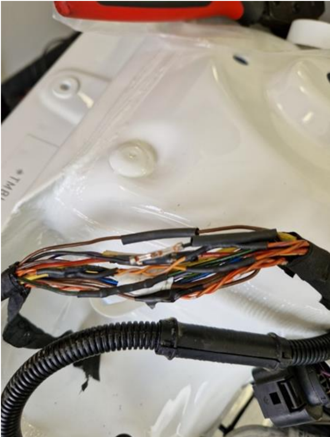
Slika 47: Izoliranje kabske napeljave
